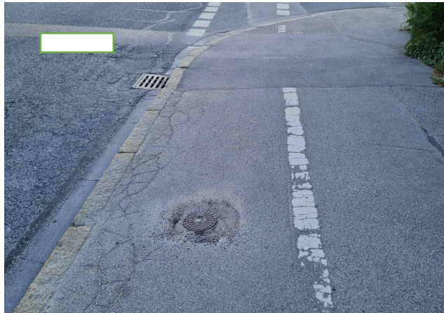
Bild 2: Ausbesserungsstellen am Belag des nördlichen Radweges
